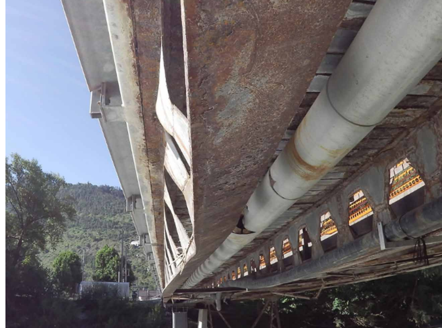
Aufgrund des hohen Pegels und des vielen Schwemmholzes wurde der östliche Träger der Fussgängerbrücke sehr stark verformt.
