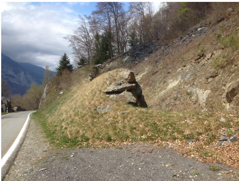
Photo 10 : Digue pare-pierres au lieu-dit "La Sasse" en bordure de la route cantonale RC 344 Dorénaz-Alesse-Champex
