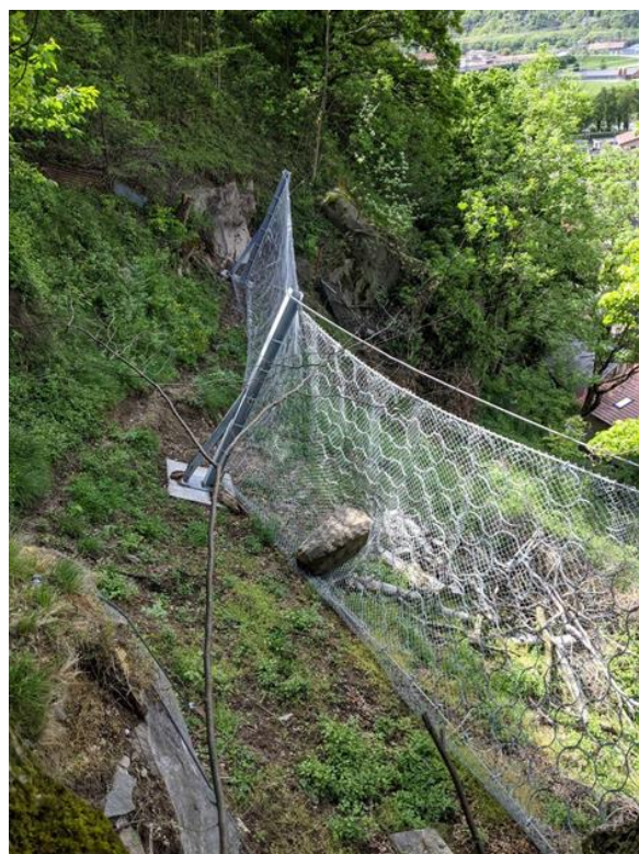
Photo 2 : Secteur Les Planches-Protorrent – Deux rangées de filets pare-pierres de 250 kJ, posées en 2019
