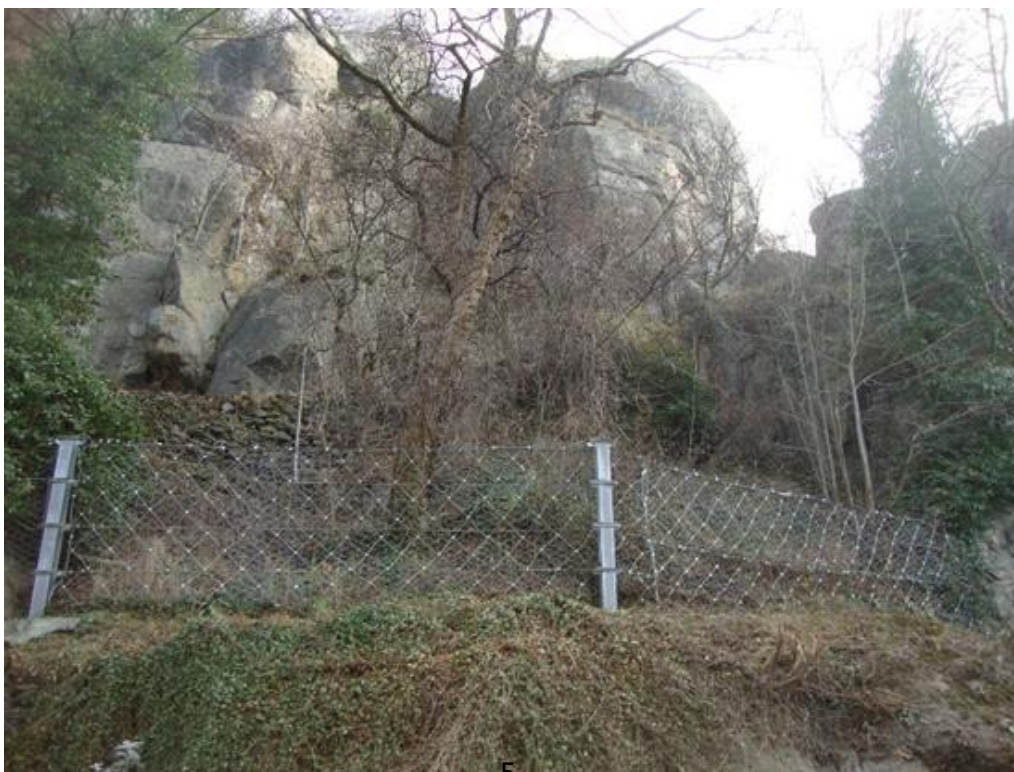
Photo 3 : Secteur Les Planches-Protorrent – Rangée de filets pare-pierres de 100 kJ, posée dans les années 2010
