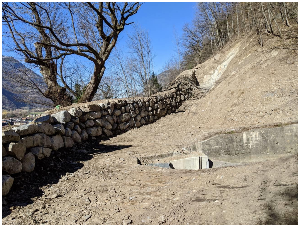
Photo 1 : Secteur Les Planches-Protorrent – Digue pare-pierres construite en 2020
