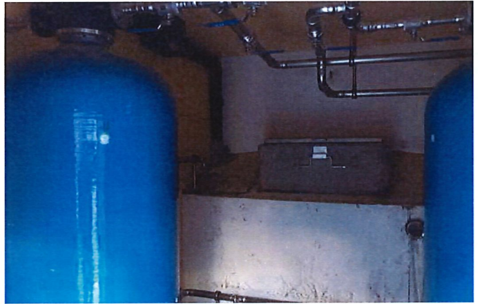
Arsen- und Uranfilter Reservoir Biffig
